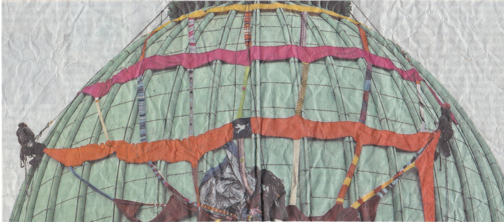
Einen ganzen Tag lang hatten Industriekletterer zu tun, um die insgesamt 200 Kilo schweren Stoffbahnen an der Kuppel zu installieren.
